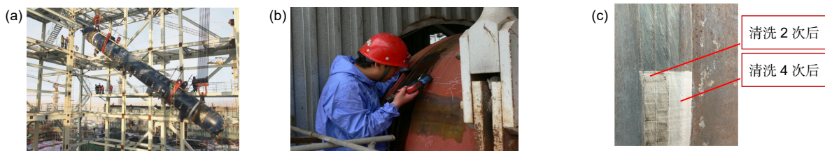
图 10 (a) 锅炉汽包罐 [12] ; (b) 清洗维护 [12] ; (c) 激光清洗设备焊缝
