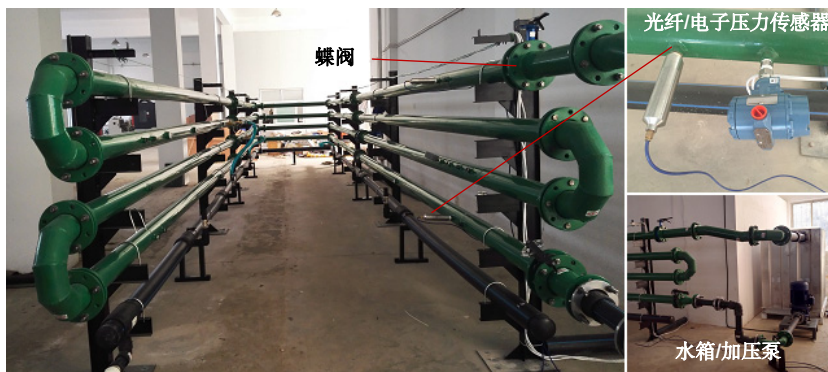
图4 管道实验平台.
